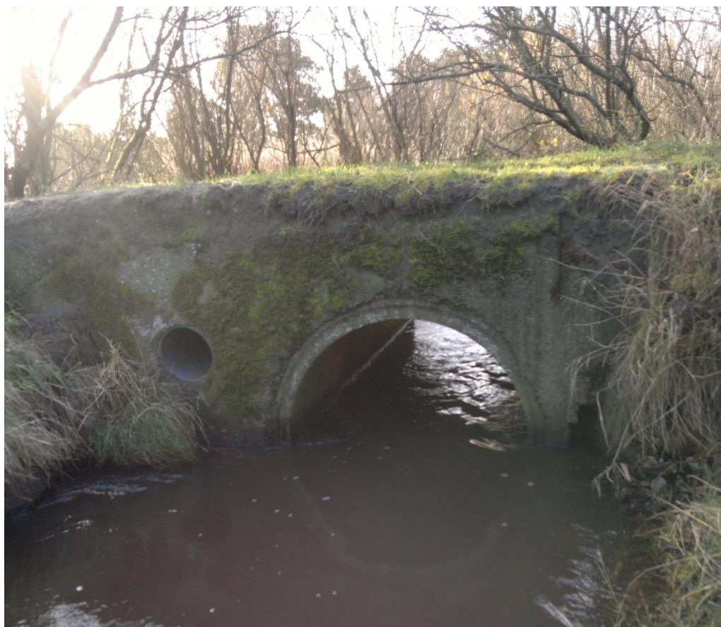
Figur 5.1. Underføring ved markvej. Rørets dimension giver anledning til opstuvning ved store afstrømninger. Nedstrøms underføringen starter stryget.
